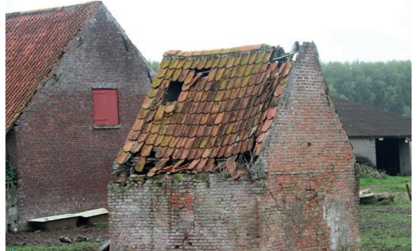
Foto. Compleet vervallen klein bakhuis onder zadeldak (< 1876), Hof Platheule, Sluissedijk 19 te Damme. Foto Arnout Zwaenepoel, 2019.
